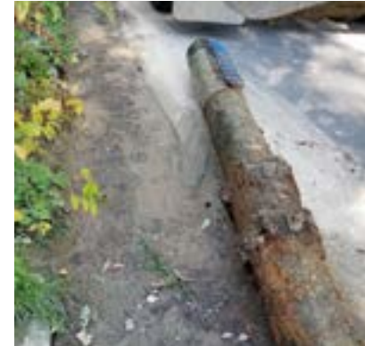
La tubería de SW Garden View Drive se reemplazó luego del colapso de la tubería principal en 2022.
